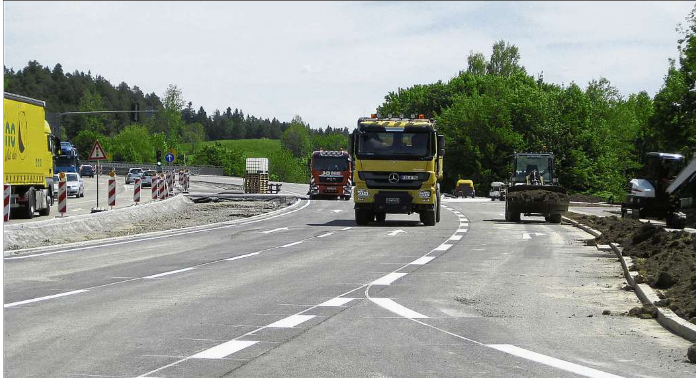
Die Straßenmarkierungen sind bereits angebracht. Bald soll der Verkehr nach rechts in Richtung Loßburg rollen. Foto: Breitenreuter
